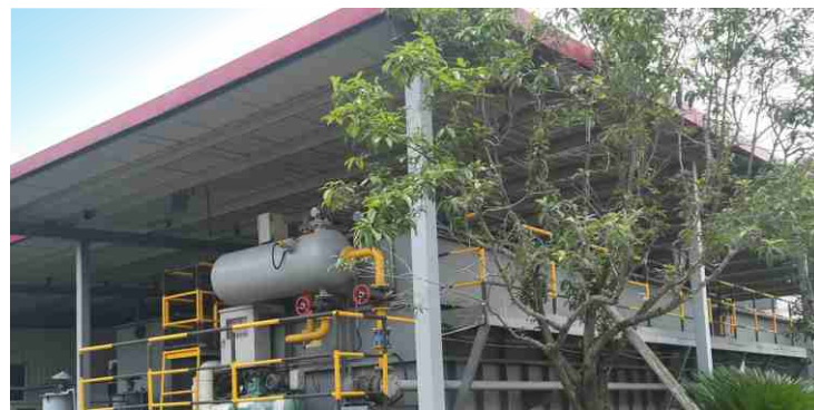
福达股份污泥脱水设备投入运行
